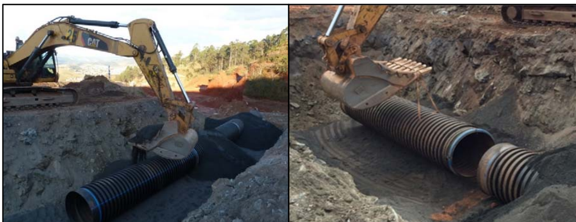
Figura 5. Instalação das seções de PEAD sem auxílio manual conforme requerido pela segurança da mina.
